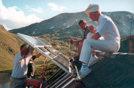
Fotovoltaik am Nebengebäude der Ignaz-Mattis-Hütte 1999
