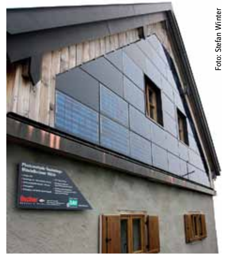
Wasserkraft, Solar- und Fotovoltaikanlagen (wie hier im Bild) bringen Strom auf die Hütten.
